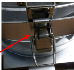
止め金具が1か所出来ない
